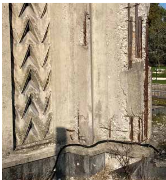
Bétons des arêtes surchargées de matière fracturée de la tour, laissant apparaître les fers de remplacement.
